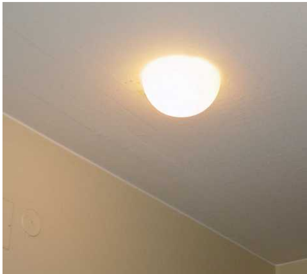
Kuva 26: Alkuperäinen porrashuoneen valaisintyyppi. Valaisimet jouduttiin korvaamaan hissiremontin yhteydessä sillä niitä ei pystynyt päivittämään vastaamaan valaisutarvetta.
