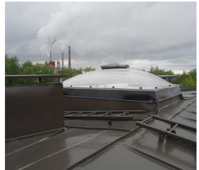
Kuva 16: 2002 hissiremontin yhteydessä uusittu kat- toikkuna sekä uusi katto vuodelta 2013.
