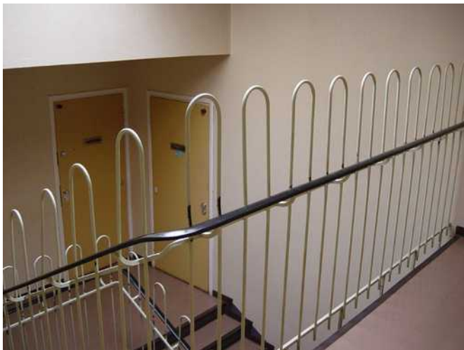
Kuva 1: Uki Heikkisen suunnittelemlle porrashuoneille tyypillinen kaideratkaisu. Kaiteet poistettiin hissiasennuksen yhteydessä. B-talon ullakotantasanteelle jätettiin kuitenkin pätkä vanhaa kaidetta edelleen käyttöön.
